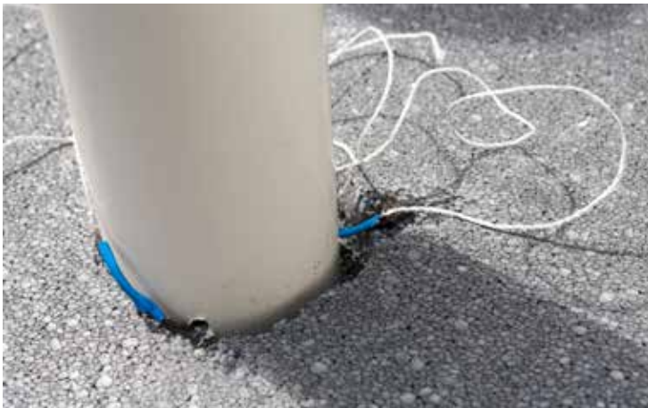
Bild 4: Kabel des Leckagenortungssystems
