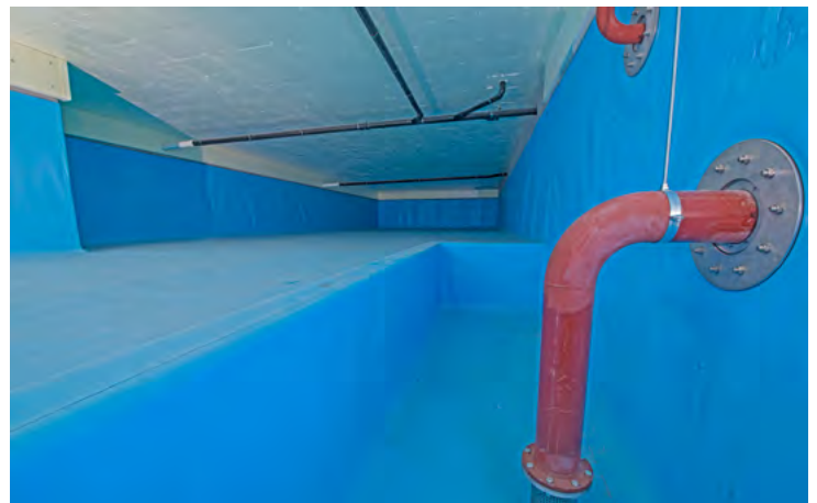
Bild 4: Dauerhaft dichte Sprinklertanks für ca. 2.500 m³ Löschwasser
