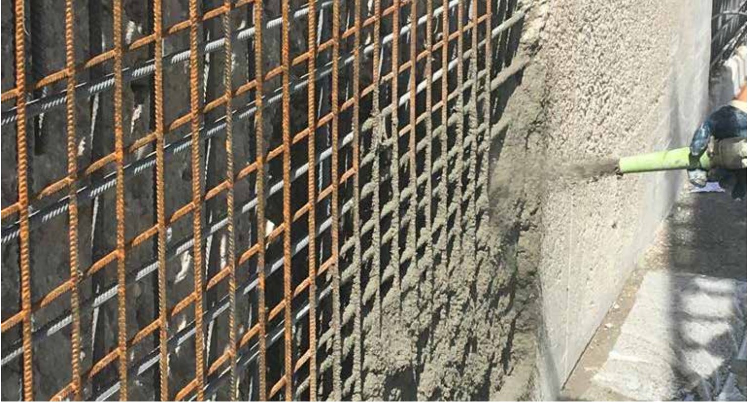
Bild 1: Maschinelles Aufbringen von Sika MonoTop ® -412 Eco auf die vom Feuer beschädigte Wand
