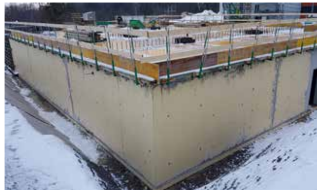
Offene Bauweise mit SikaProof® A+: Nach Ausschalung müssen alle Ankerlöcher abgedichtet werden.
