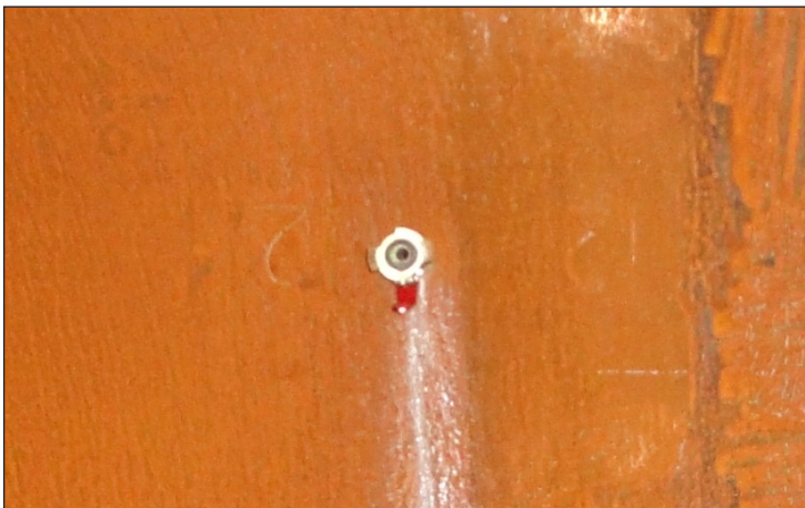
Bild 7: Verpressöffnung mit Absperrhahn
