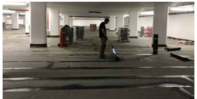
Vollflächiges Aufklämmen der 2. Bitumen-Abdichtungslage Dörr-Tiropont® PL-2 unter Walzasphalt (AC) bzw. Dörr-Tiropont® PL-5K unter Gussasphalt (MA)
