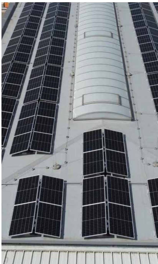
Bild 4: Nutzung der Sonnenenergie auf dem fertigen Dach des Gebäudes
