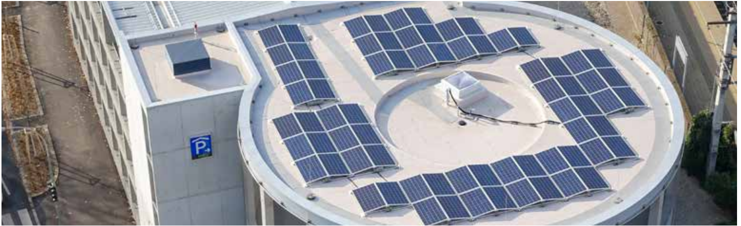
Bild 8: Nutzung der Sonnenenergie auf dem Dach der P+R Anlage in Baden
