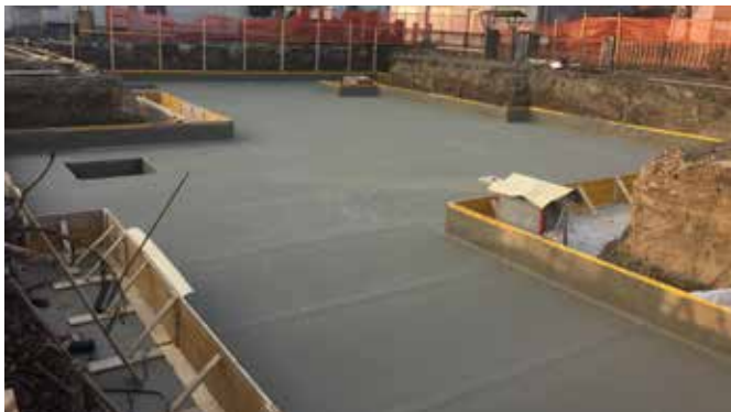
SikaProof® A+ unter der Fundamentplatte auf der Sauberkeitsschicht
