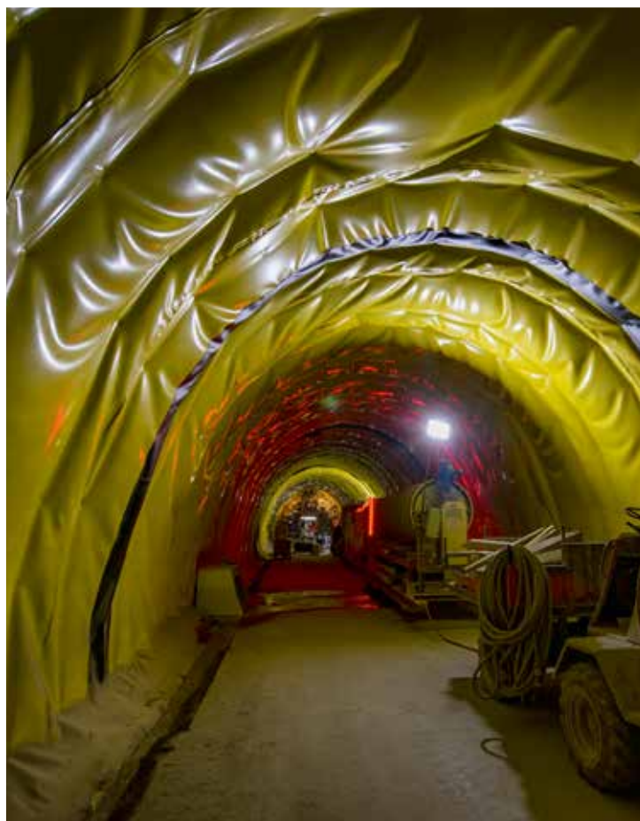
Bild 2: Rettungstunnel mit Profil RR
