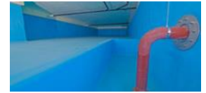
Sprinklertanks- und Wasserbecken
