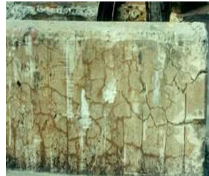
Alkali Kieselsäure Reaktion Klassische netzartige oder strahlenförmige Risse
