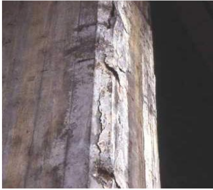
Betonabplatzungen aufgrund von Korrosion
