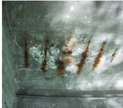
Korrosion nahe der Betonoberfläche
