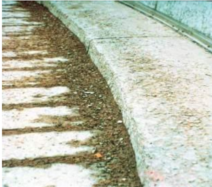
Schäden durch Frost / Tausalz
