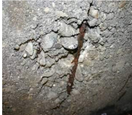
Geringe Betonüberdeckung / Kiesnester
