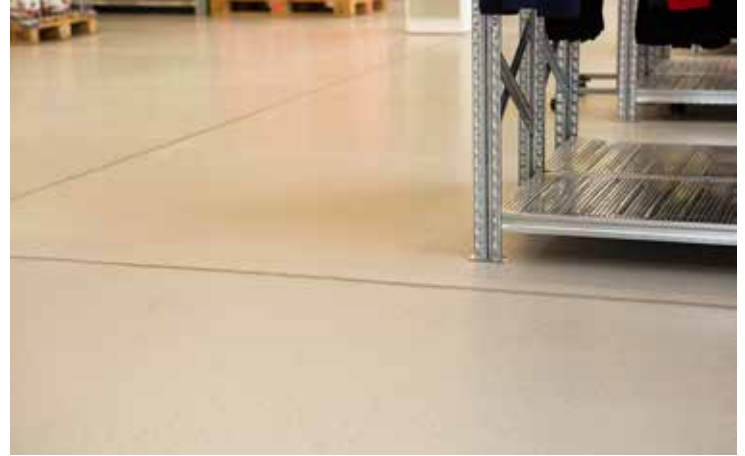
Bild 2 - Sauber gearbeitete Fugen erleichtern die Reinigung
